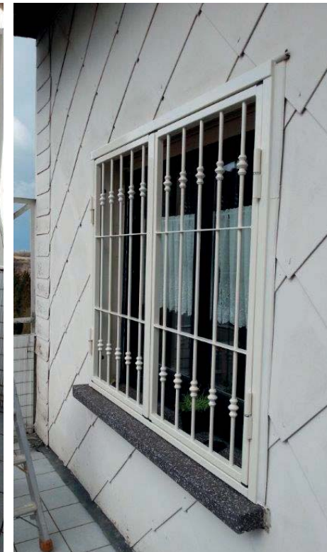
DEA L mit Einbauzarge am Haus wg. Platten
