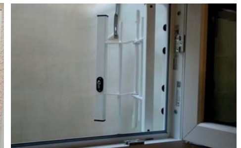
DEA Silber geöffnet im Kellerschacht
